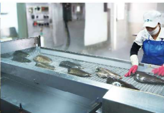
I.Q.F急速冷凍設備
